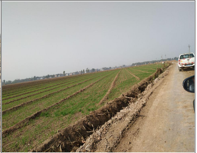
施工便道排水沟淤积现象
