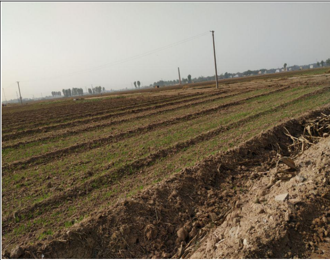
施工便道排水沟淤积现象
