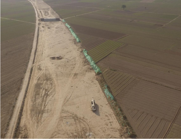
说明：对剥离堆放的表土未进行临时拦挡防护
