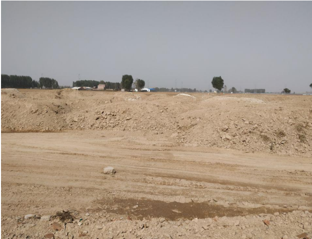
说明：临时堆土裸露面未进行覆盖。
